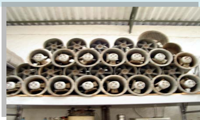
IMG 65 Ventoinhas Exaustores
