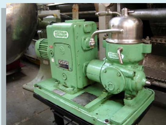
IMG 30 Centrifuga WEST FALIA SEPARATOR D4740 TIPO: KA 1-06-025 NO: 1704566 MOTOR PLV: 1,5 KW VELOCIDADE RPM: 5000 A 10000 LIQUIDO PESADO: 1,1 SOLIDOS: 1,2-9,0 DENSIDADES:
