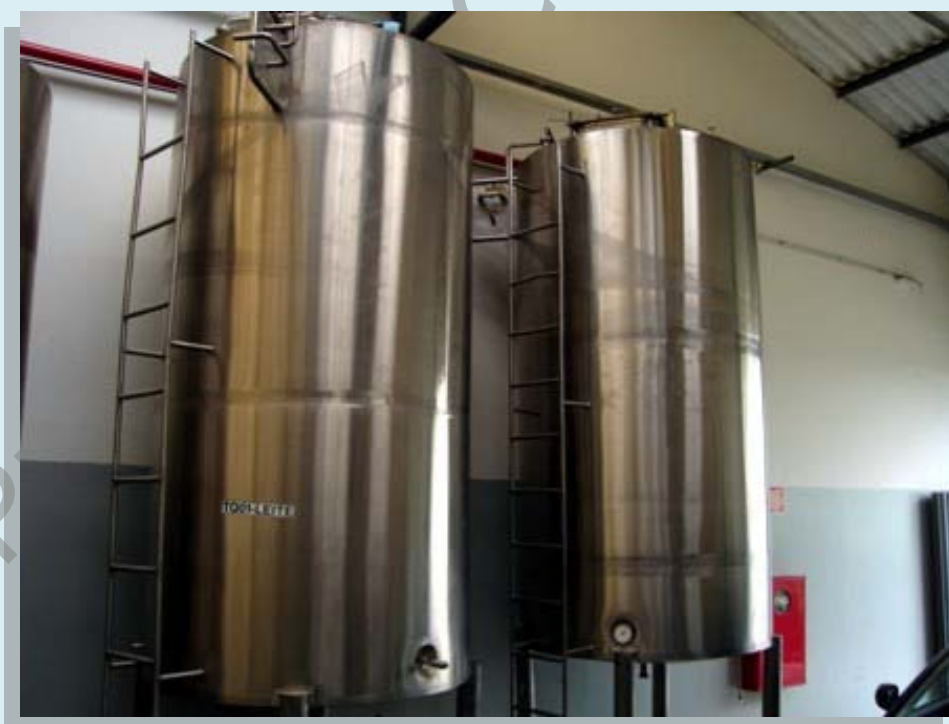
IMG 260 Tanque de Acabamento Sanitário Volume: 5.000 Litros
