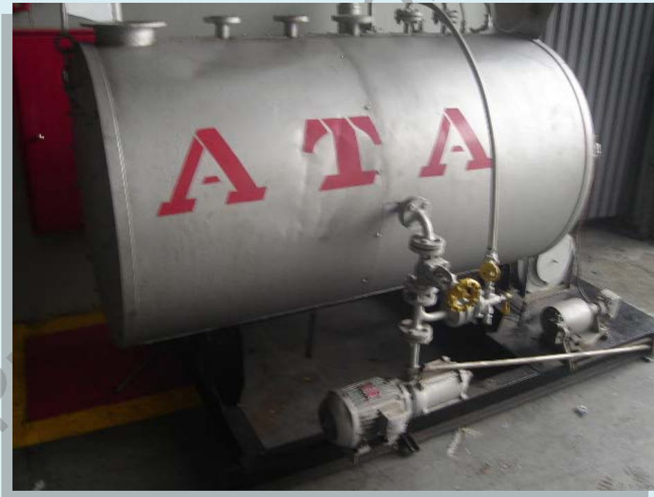
IMG 26 Caldeira Marca: ATA Tipo: H MOD 3 Combustão: óleo
