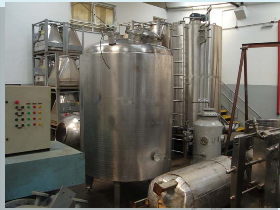
IMG 243 Tanque Acabamento Sanitário Volume: 3.600 Litros
